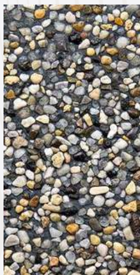
Sello Lavado Estacionamiento Exterior
